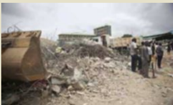
Redningsarbeidere utenfor den kollapsede bygningen.
